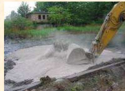
Konditionieren des Schlammes im Erdfaulraum
